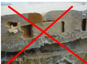
Geen voeghout tussen de planken
